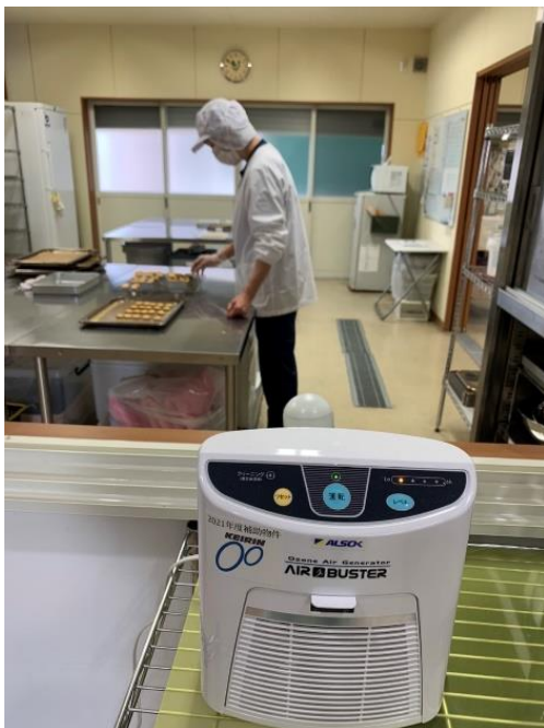
食品棟に設置
